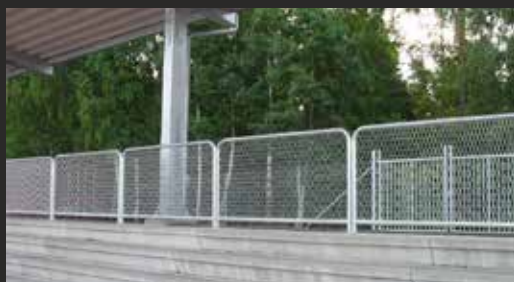
Strekkm metall rekkverk
