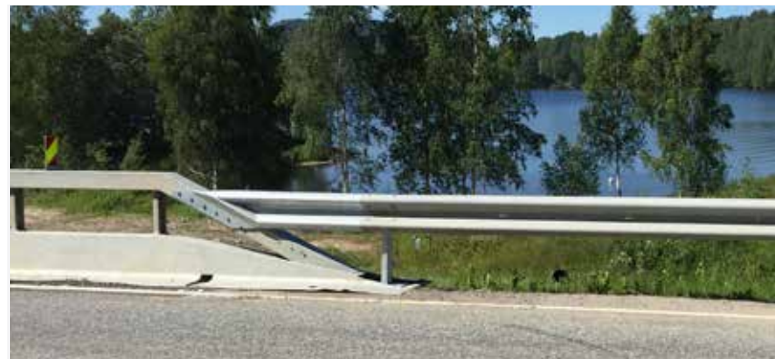
Vegkant; Ensidig overgang VG-W rekkverk
