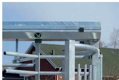
Passasjeindikator, led lys og takbelysning
